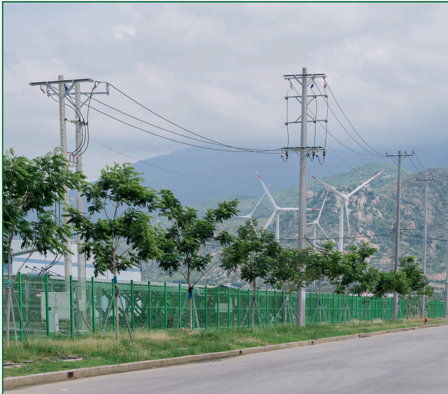
Nguồn cung cấp điện - chiếu sáng
