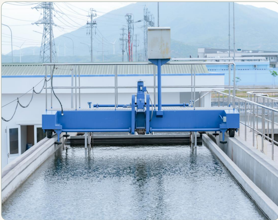
Hình trạm xử lý nước thải Module 01
